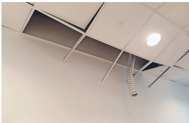
Zakaj so se zrušile nove mavčne plošče, ne vedo natančno.
